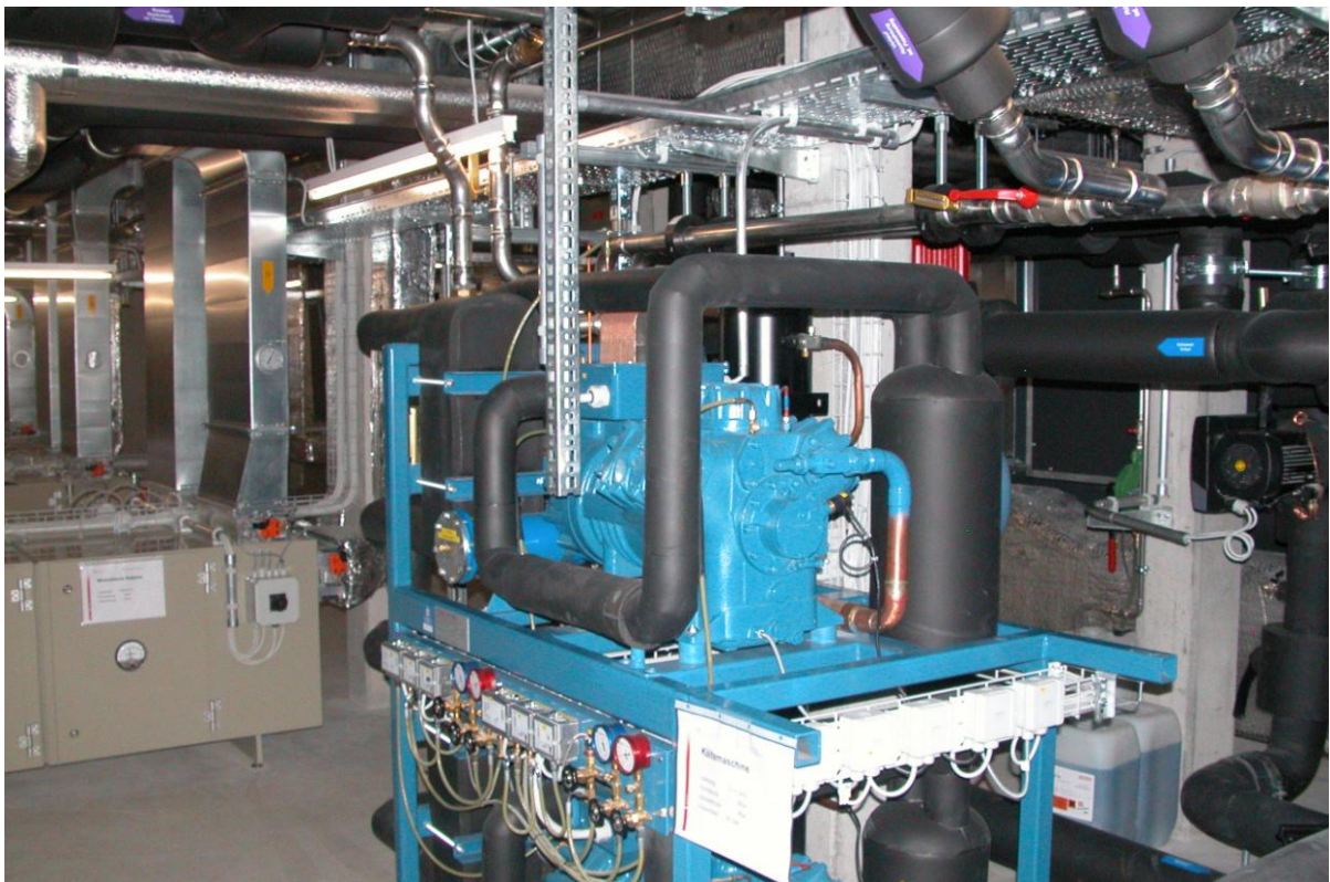
Das Kellergeschoss des neuen Hightech-Gewächshauses von ACW ist vollgestopft mit modernster Technik.
