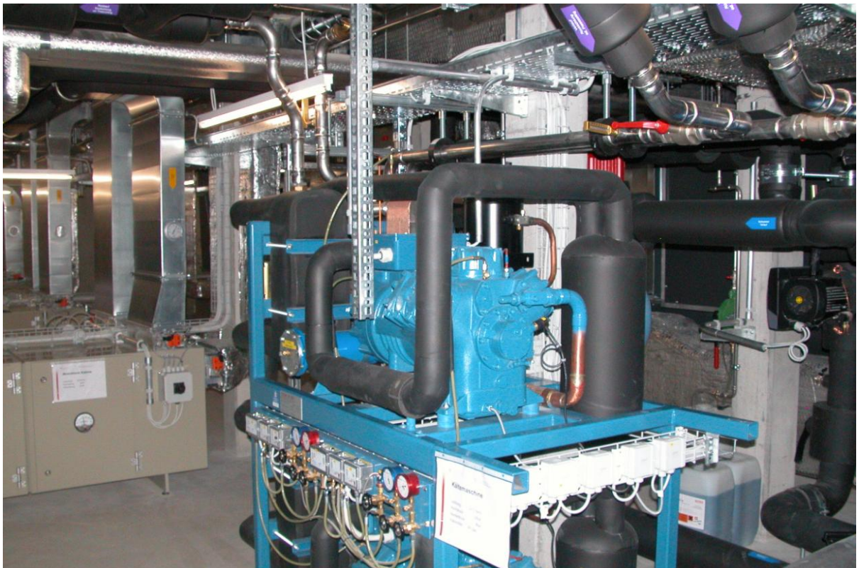
Le sous-sol de la nouvelle serre high-tech d'ACW regorge d'équipements techniques ultramodernes.
